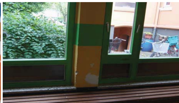
Sich lösender Innenputz (Turnhalle)
