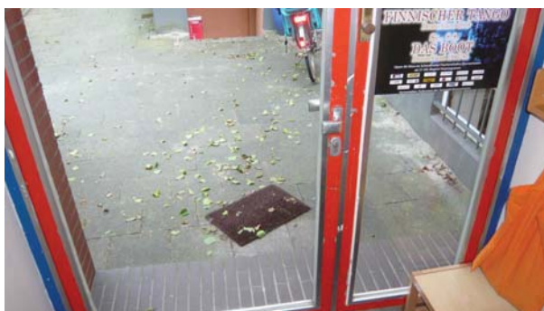
Metalleingangstür mit Einfachverglasung
