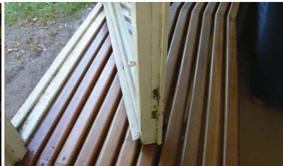
Fenster ohne Dichtung
