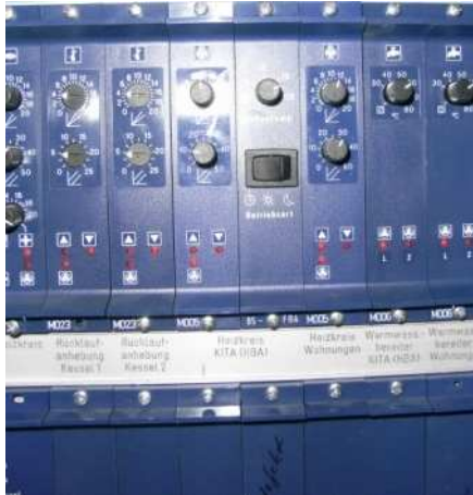
Steuerung der Kita-Heizkreise
