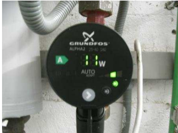
Heizkreispumpen in der Heizzentrale
