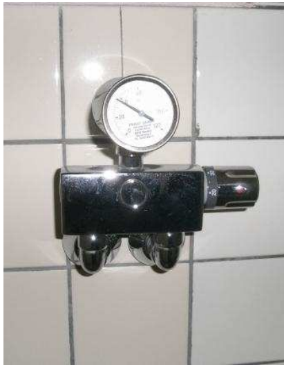
Zentrale WW Temperaturregelung
