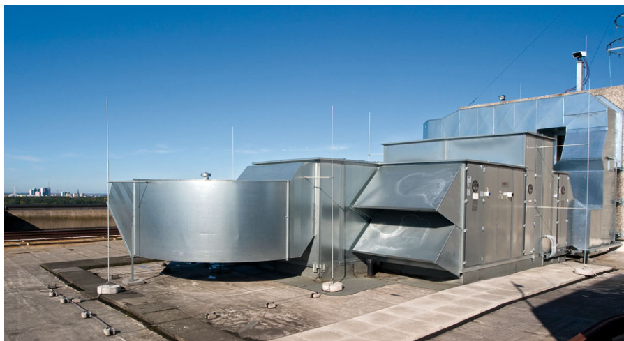
Die neu errichtete zentrale Lüftungsanlage auf dem Dach des Klinikums.
