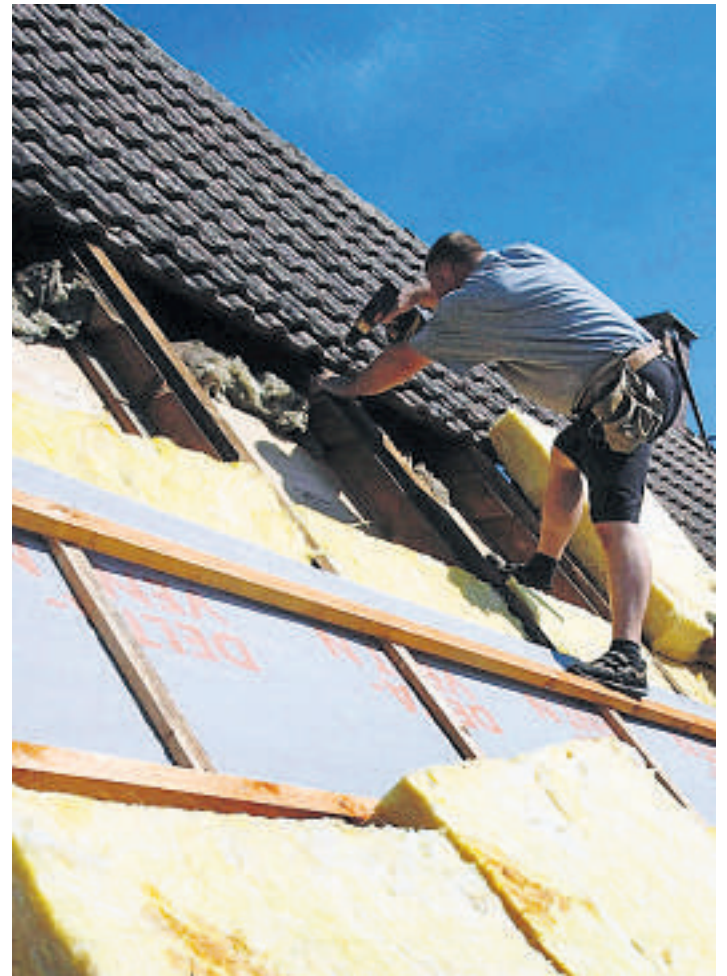
Die Energie von bis zu 26 Liter Öl können pro Quadratmeter durch einen ungedämmten Dachstuhl im Jahr sinnlos entweichen. FOTO: DPA
