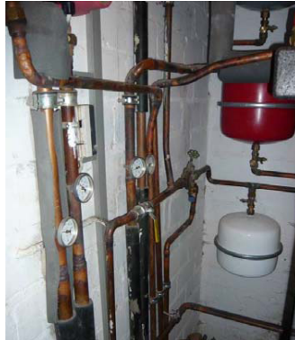
Abb. 8: Ungedämmte Rohrleitungen im Heizungsraum eines Wohngebäudes (Foto: BEKS)
