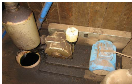
Abb. 6: Ungeregelte Vakuumpumpe in einem Milchviehbetrieb (Foto: BEKS)
